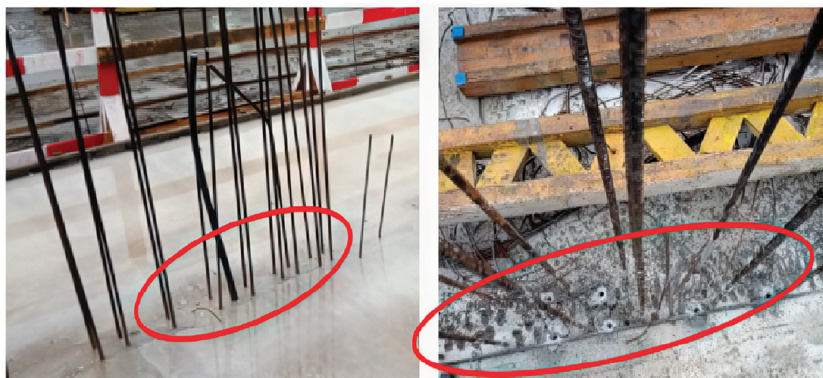
Рис. 3. Нарушение шага установки стеновых каркасов
