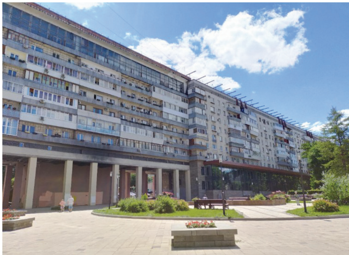
Рис. 1. Металлические конструкции стоек перголы на крыше комплекса «Шанхай» (вид с ул. Молодогвардейская, 2023 г.)
